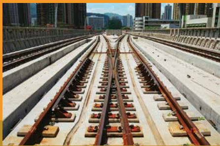
Trackwork Engineering 路軌工程 East Rail Ma On Shan Extensions 東鐵馬鞍山延線
